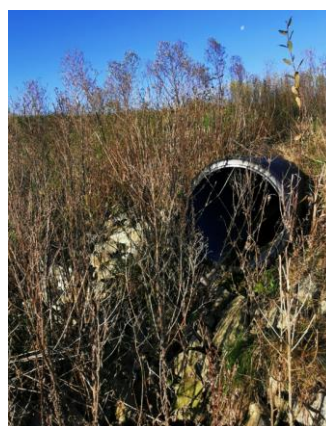
Photo 9 : collecteur ouest du bassin tampon
