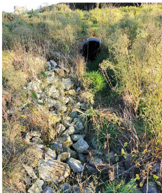
Photo 7 : collecteur Est du bassin tampon
